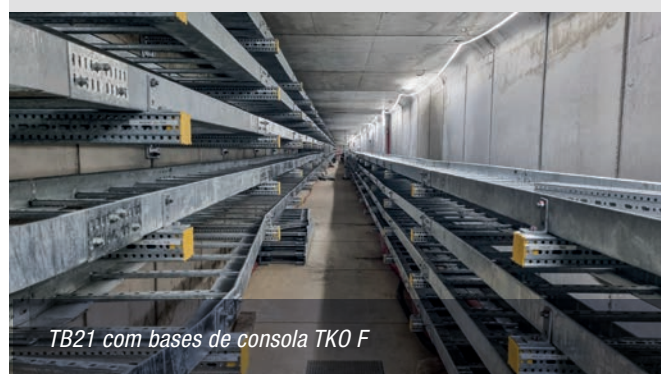
Suportes siFramo no edifício Tokamak
